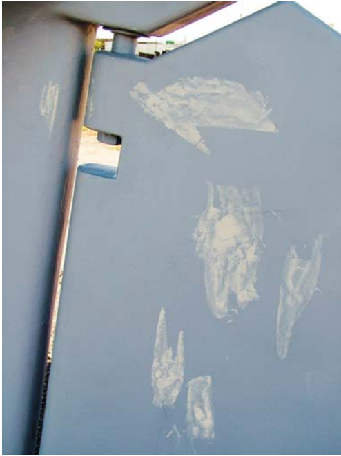
Efter første lag primer ser vi tydeligt nogle slibemærker bl.a. på roret, som vi dækker med Epoxy Primer og sliber af, før vi igen lægger tre lag primer på.
