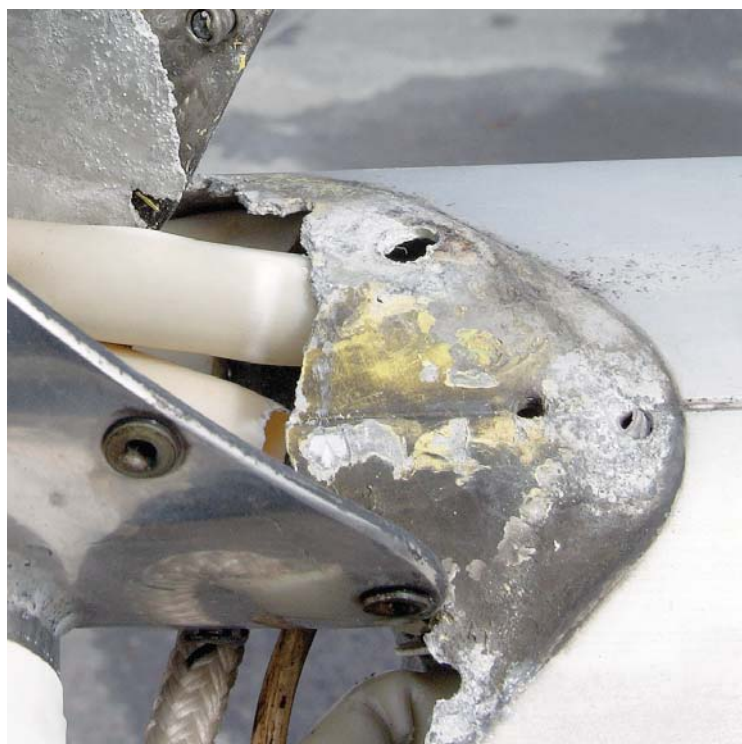
Her ses hvordan et aluminiumsprofil er blevet tæret og knækket, på grund af direkte kontakt med et beslag af rustfri stål.
