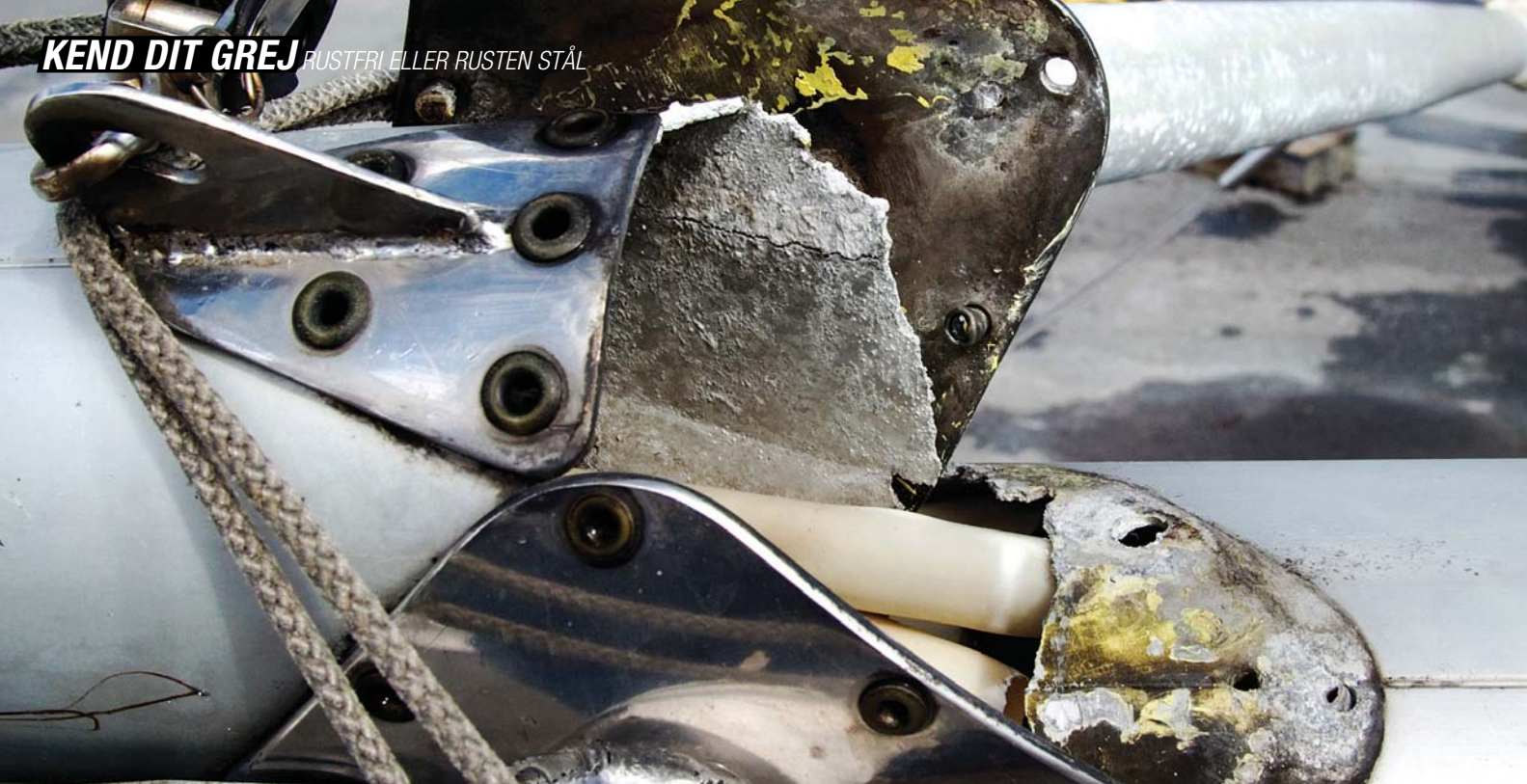
Der skal isoleres mellem rustfri stål og aluminium. Her er der tydelig tæring ved rustfri beslag og popnitter. Vi vil dog ikke påstå, at masten er knækket på grund af tæring.
