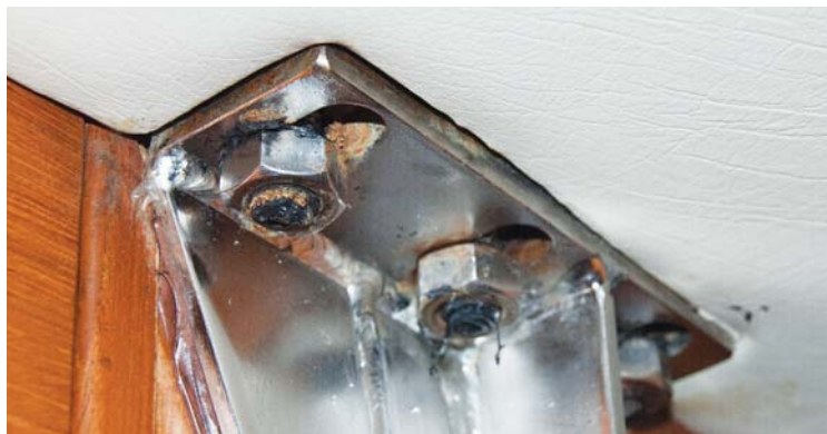
Klare tegn på utæthed; og desuden en rustfri legering som ikke er helt rustfri. Her er lækagen stoppet midlertidigt ved hjælp af Crack Sealer.
