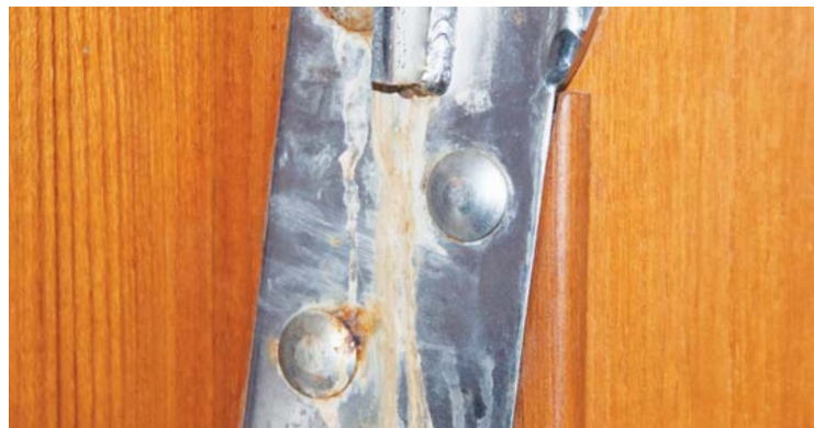
Her er vandet kommet ned langs røstjernet. Gennemføringen til beslaget på dæk er utæt. Der er ikke sket alvorlige skader – endnu.
