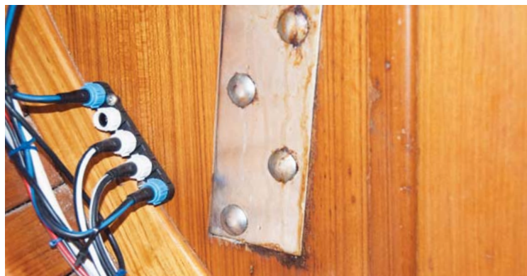
Begyndende fugtskade i hovedskot, skabt af utæthed ved røstjern.
